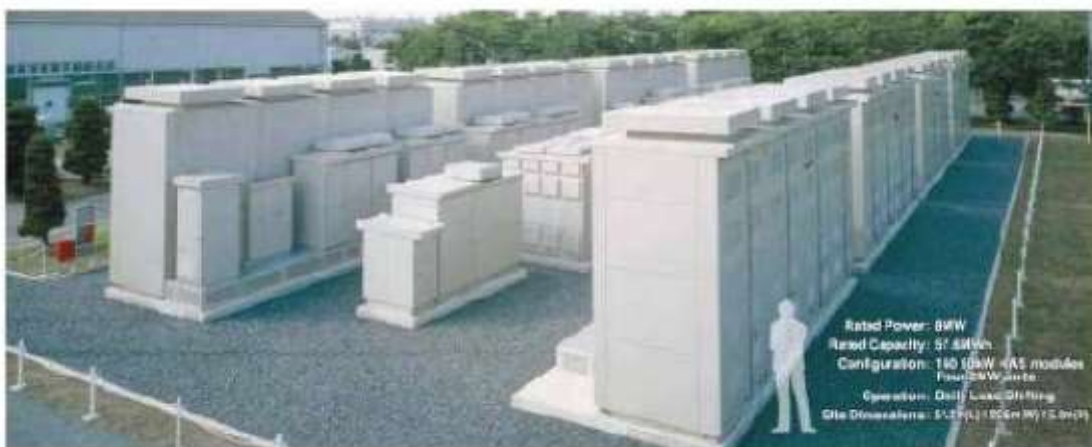
Рисунок 1.13 - Накопительный блок на базе химических элементов мощностью 8 МВт, Япония
