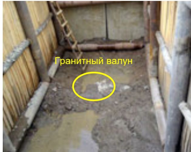
Рисунок 4.63 – Рабочий котлован для монтажа механизированной установки не достиг проектной глубины
