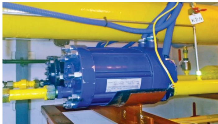
Рисунок 17 – 2 ТДУ НПК «НТЛ» мощностью 2 кВт на ГРС г. Кировграда [48, 49]
